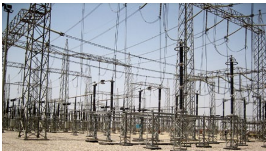
Unitrafo levererar hjälpkrafts- och jordningstransformatorer när ABB bygger ut en befintlig transformatorstation i Ammara i södra Irak.
